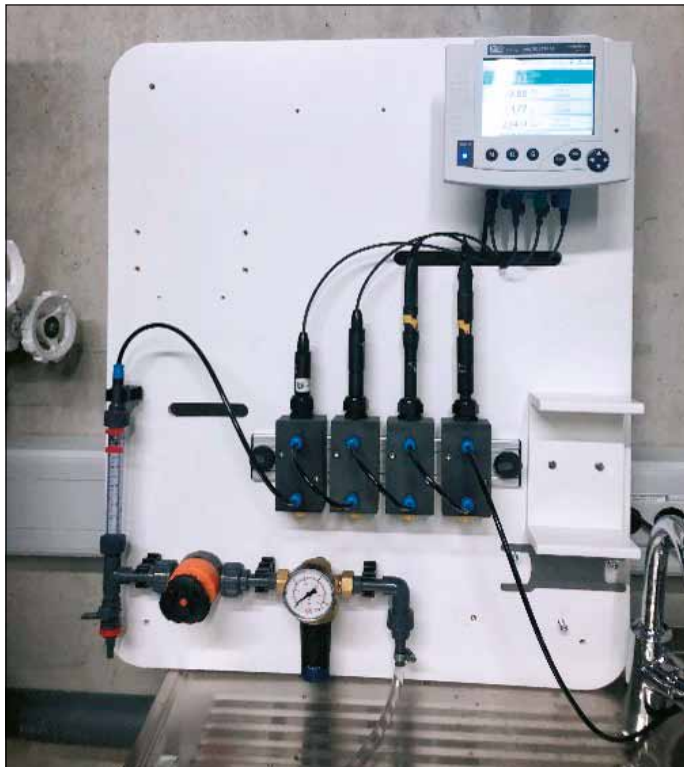
Abb. 4: Die WTW-Trinkwassertafel im Wasserwerk Mörscher Wald bei Karlsruhe.
