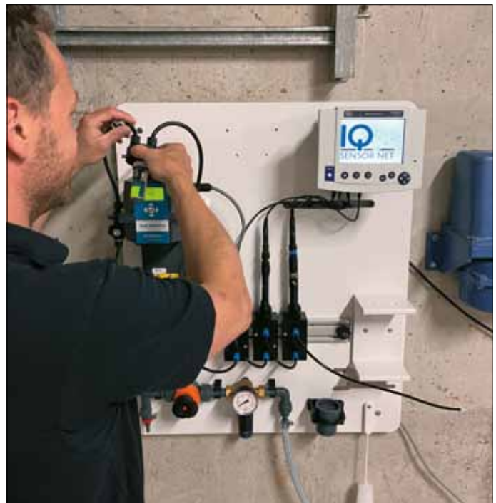
Abb. 3: Installation und Inbetriebnahme der WTW-Trinkwassertafel im Wasserwerk Aschaffenburg
