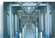
Filteranlage zur Entfernung von Schadstoffen im Wasserwerk Blaubeuren
