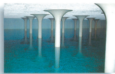
Trinkwasserbehälter – Speicherraum für das kostbare Nass
