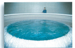
Wasserzulauf im Scheitelbehälter Amstetten – in großen Rohrleitungen gelangt das Trinkwasser zu den Kunden
