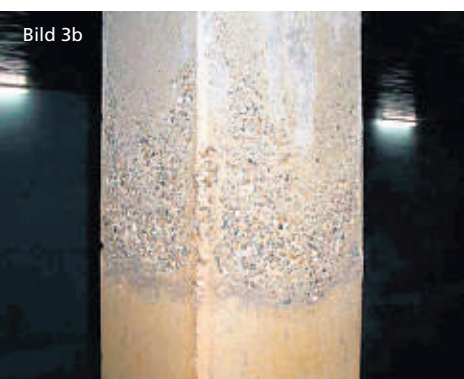
Bild 3a/b: Betonkorrosion im Bereich der Wasserwechselzone durch intensiven Einsatz von Hochdruckreinigern und sauren Reinigungsmitteln
